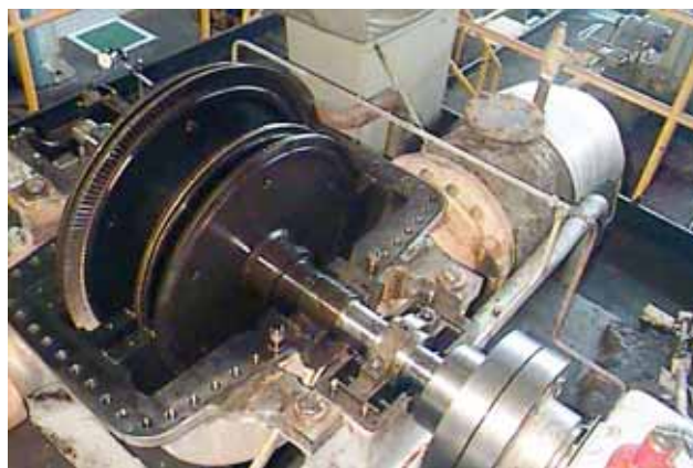
Figura 14.2.1 - Turbina à Vapor aberta para reparos
