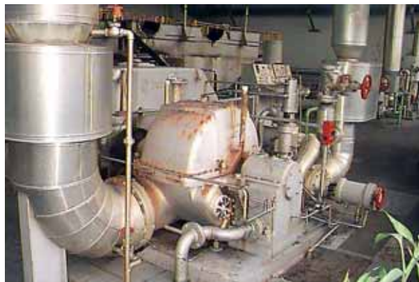
Figura 14.2.2 - Turbina à Vapor em funcionamento
